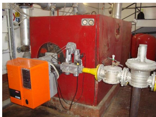
Figura 4.11 - Particolare generatore di calore
