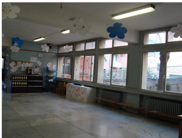
Figura 4.5 – Particolare radiatore su parete esterna
