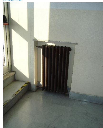
Figura 4.6 - Particolare radiatori su parete interna
