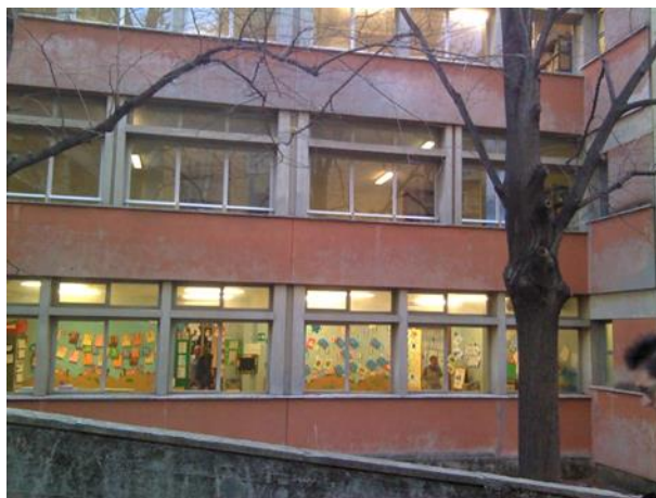
Figura 4.4 – Rilievo termografico serramenti
