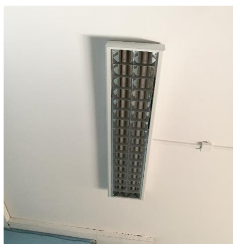
Figura 4.15 - Particolare dei corpi illuminanti ubicati nelle aule
